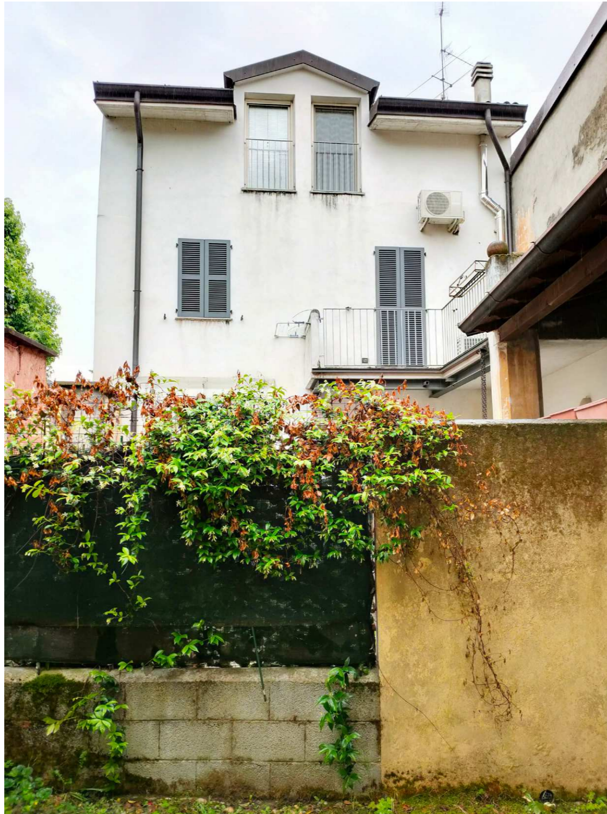
V17. Il fabbricato residenziale identificato al mappale 181 sub.701 ripreso dal giardino meridionale
